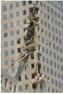
Fig.1 : Poutres d'acier empalées dans un immeuble
